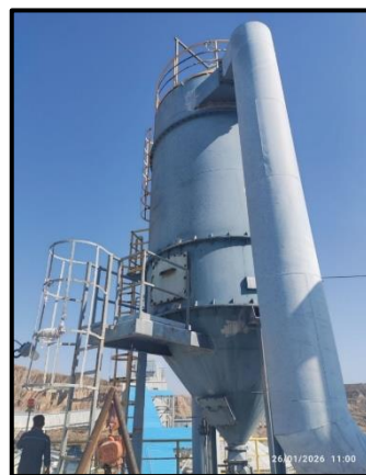
بگ فیلتر ایستگاه ۳
