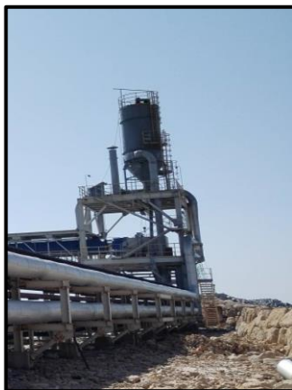
بگ فیلتر ایستگاه ۱
