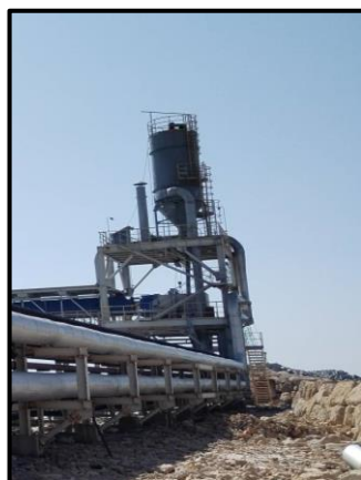
بگ فیلتر ایستگاه ۱
