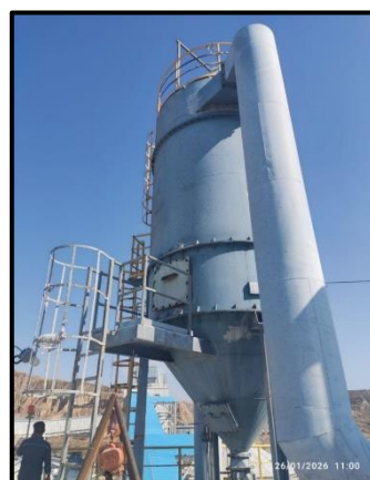
بگ فیلتر ایستگاه ۳
